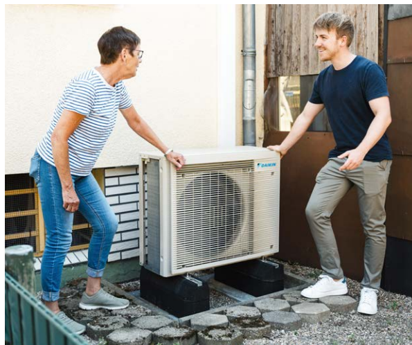
So sieht die kompakte Klima-Wärmepumpe aus, die in den Wohnungen von Marc Fechtner (r.) für gutes Klima sorgt.
